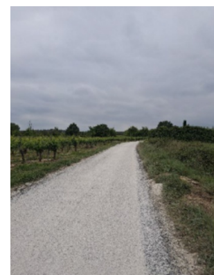
Chemin de Berthézane : Bi-couche réalisé après les travaux d'Eau de Nîmes. L'entreprise doit reprendre les anomalies signalées par la mairie.
